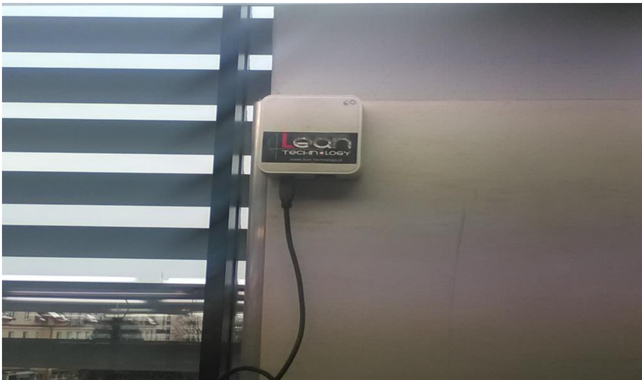
Jedna z zamontowanych na hali produkcyjnej anten odbiorczych.
